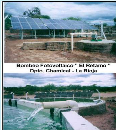
Figura. 3. Sistema de bombeo Fotovoltaico
